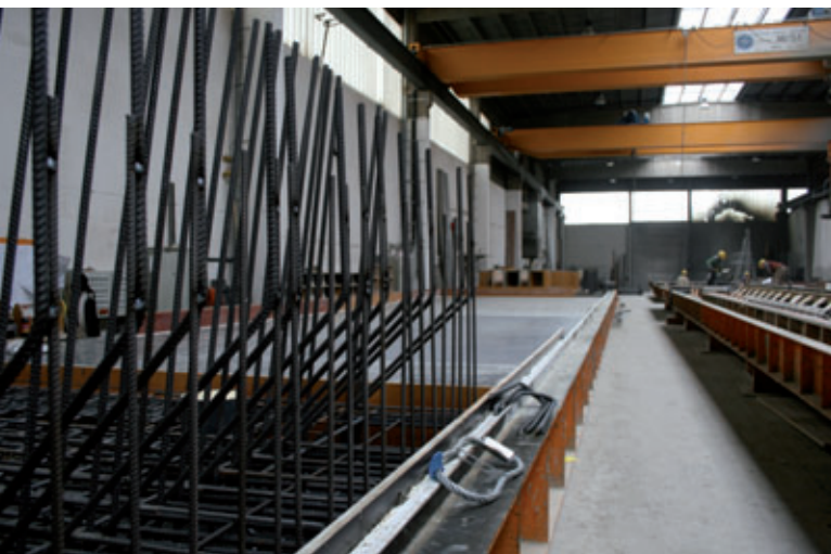
Mehrere Kipptischen mit Längen bis 27 m und 5 m Breite erlauben die Fertigung von großflächigen Betonfertigteilelementen
