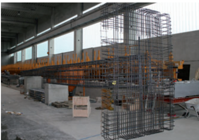
Die Bewehrung für Stützen mit integrierten Fundamenten können jetzt in einem gefertigt werden
