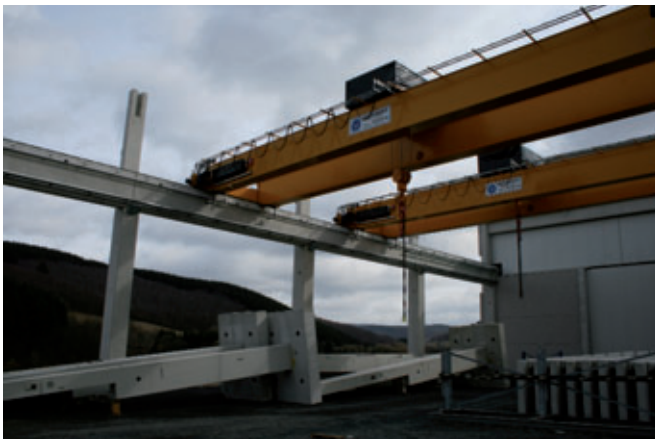
Die Stützen der Kranbahn wurden als komplette Hallenstützen für eine spätere Erweiterung ausgeführt
