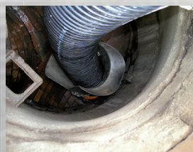
Einziehschuh im Schacht
