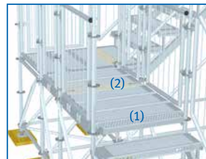
Exemple d'application de la Poutrelle-fente (1) et du recouvrement fente (2) (Recouvrement fente voir page 22/23)
