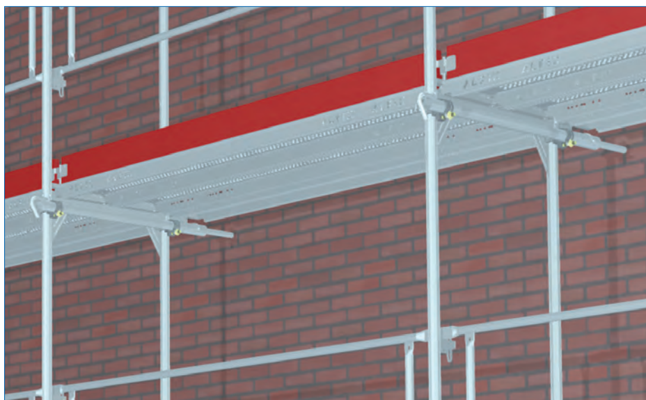
Paire d'ancrage ITE montés sur mur du bâtiment sans ITE
