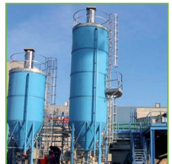
» SILOS VENT FILTERS
