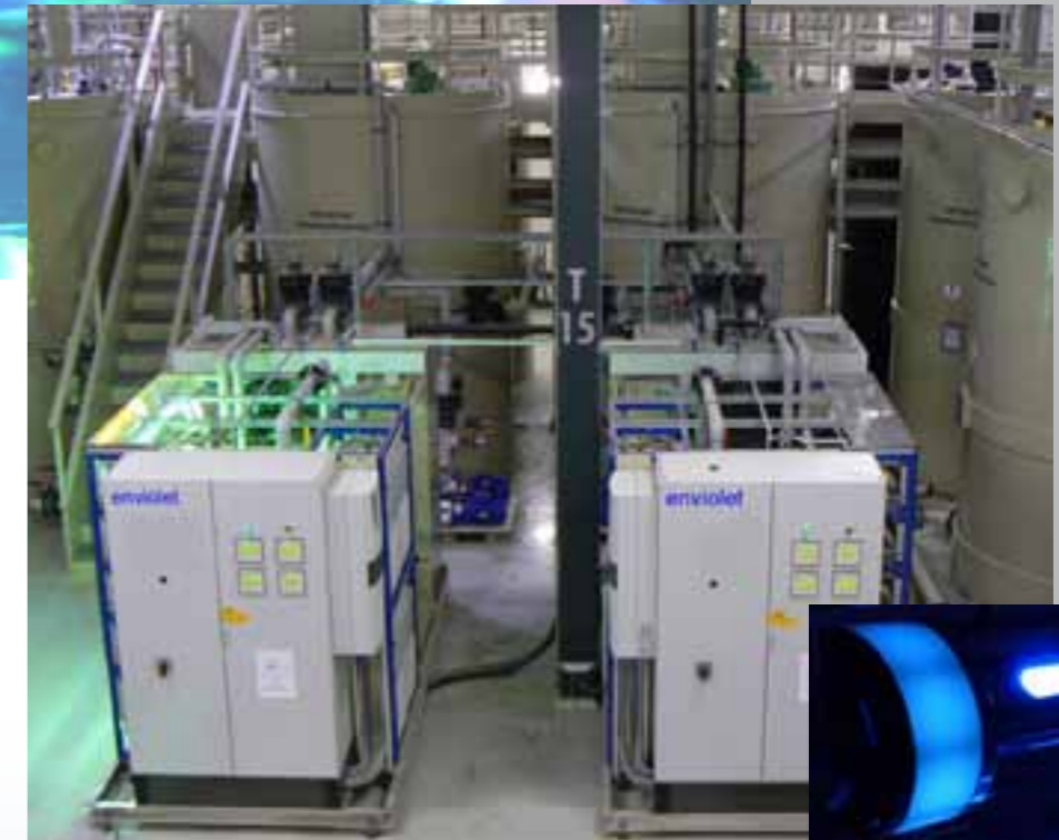
Redundante Anlagenausführung Redundant installation
